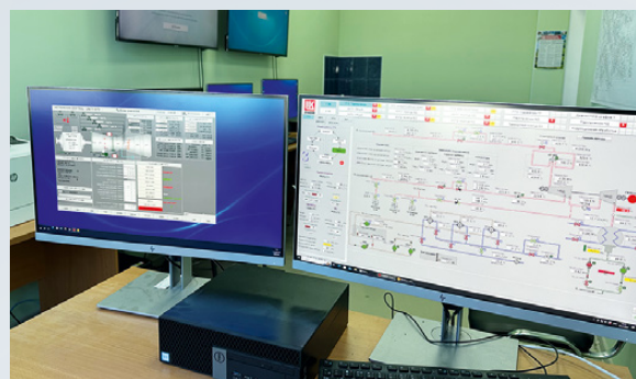
Тренажёры имитируют работу основного и вспомогательного оборудования ТЭС
